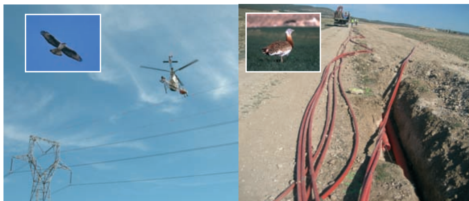
Figura 18. Izquierda: balizamiento con espirales salvapájaros de los cables de tierra en la línea Litoral-Asomada que atraviesa la ZEPA Sierra de Almenara, Moreras y Cabo Cope para aumentar su visibilidad por el águila-azor perdicera (en peligro de extinción, Ley 7/1995 de Fauna Silvestre). Derecha: electrificación rural, línea soterrada a su paso por la ZEPA Estepas de Yecla, para proteger a la avutarda común (en peligro de extinción, Ley 7/1995 de Fauna Silvestre).
