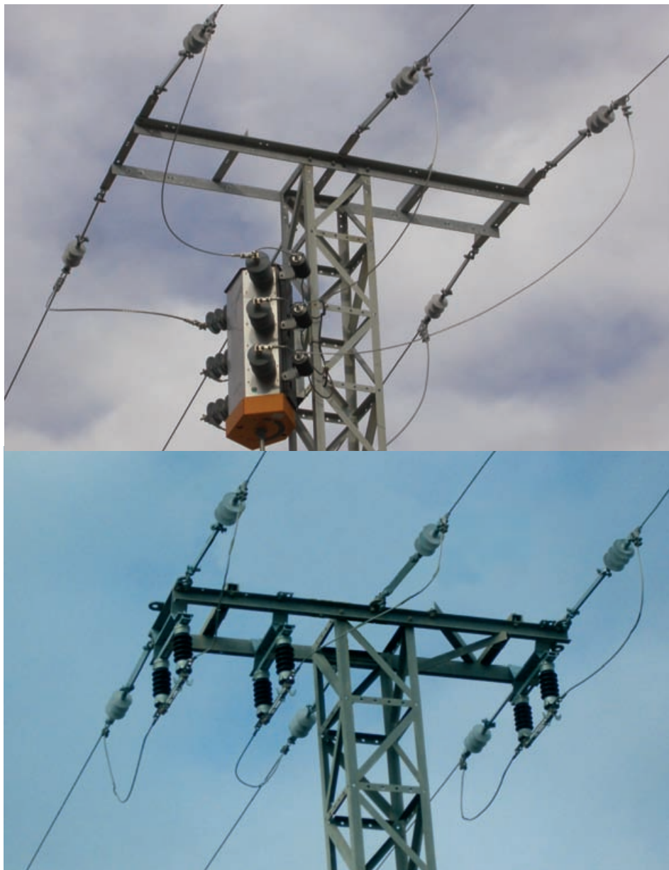
Figura 31. Correcciones propuestas. Las fotografías muestran apoyos en proceso de corrección pendientes de la colocación del material aislante.
