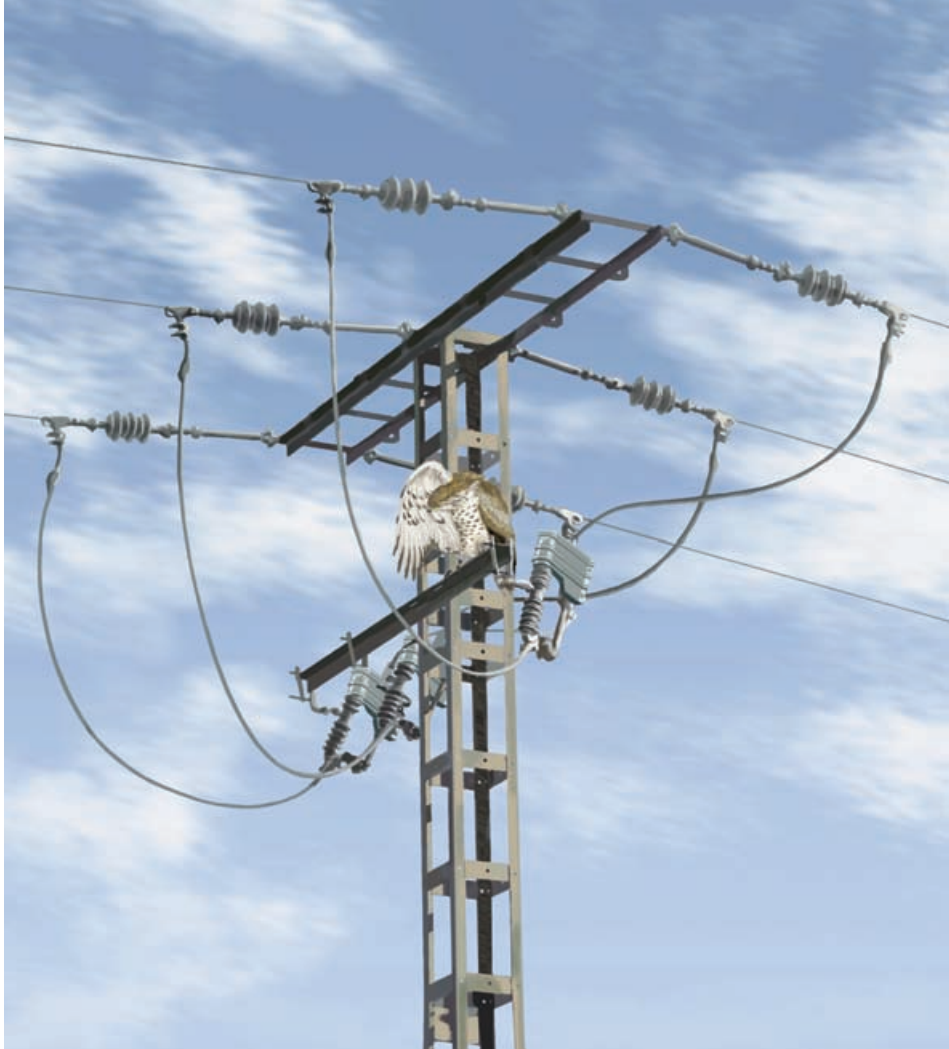
Figura 34. Solución para apoyo de protección y maniobra, con fusibles-seccionadores. Una culebrera europea se asea el plumaje. Las aves grandes y medianas se posan más frecuentemente en la cruceta superior, aunque pueden hacerlo en cualquier punto.
