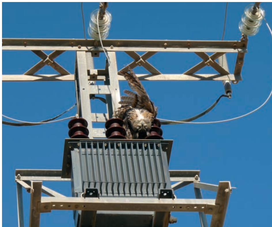
Figura 15. Apoyo fin de línea CTI donde se electrocutó un búho real en Alhama de Murcia. Es posible que los cadáveres en estos apoyos aparezcan con menos frecuencia en los recorridos sistemáticos de líneas ya que son retirados por la empresa de mantenimiento, a veces el mismo día del accidente.
