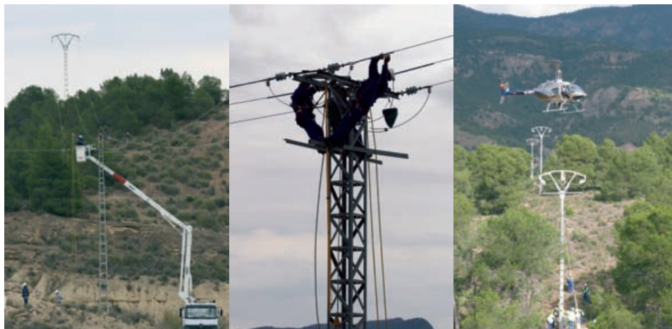
Figura 19. Corrección de apoyos con medidas antielectrocución por el Proyecto LIFE de tendidos eléctricos. Izquierda y centro, reubicación y aislamiento de elementos del armado, línea eléctrica propiedad de Iberdrola en el entorno del Embalse de Puentes, Lorca (ZEPA Gigante). Derecha: la sustitución de apoyos a veces es necesaria en el caso de que los antiguos fustes no soporten la nueva cruceta, línea de particular (ZEPA España).
