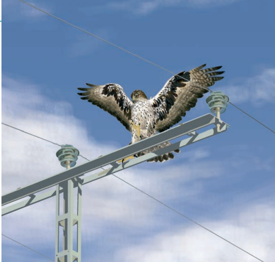
Figura 3. Un águila-azor perdicera, posándose en un apoyo con aisladores rígidos, montaje “0”. La envergadura de esta ave permitiría el contacto fase-fase, sin embargo, en apoyos metálicos, el contacto con una sola fase es suficiente para que el animal posado se electrocute (contacto fase-tierra).
