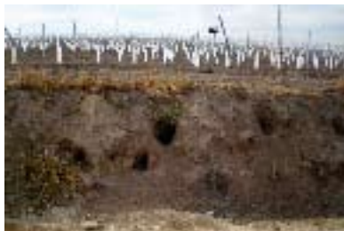
Madrigueras en talud.
