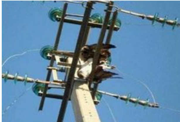
Illustration 20: Aigle de Bonelli électrocuté sur un pylône électrique -type interrupteur aérien IACM - (C. Audic 2008)
