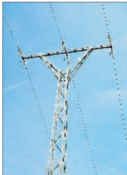
Poste eléctrico con puentes por debajo del travesaño.
