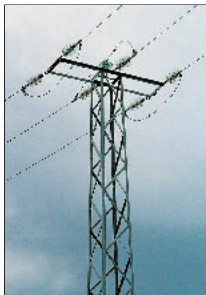
Poste eléctrico con un puente por encima del travesaño.
