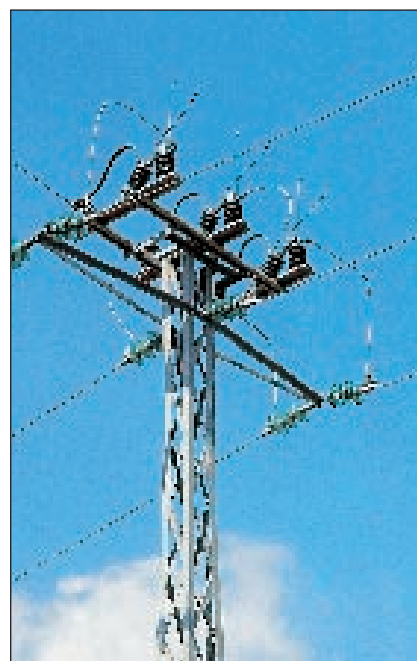
Poste eléctrico con seccionador en cabecera.
