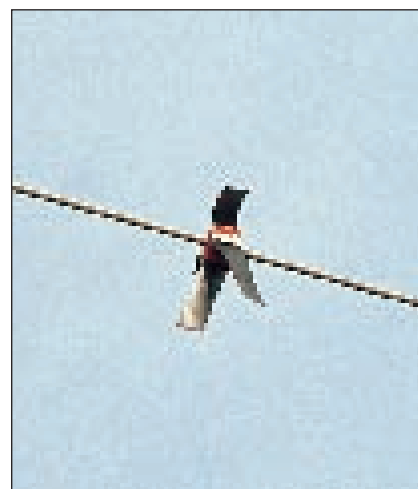
Línea eléctrica modificada con la medida anticolidión tiras de neopreno
