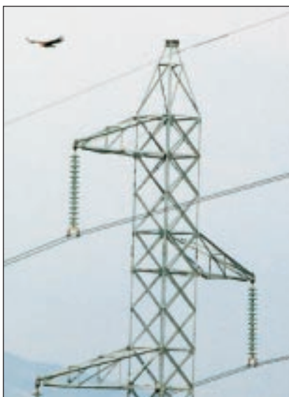
Línea de transporte con cable de tierra. Foz de Lumbier.
