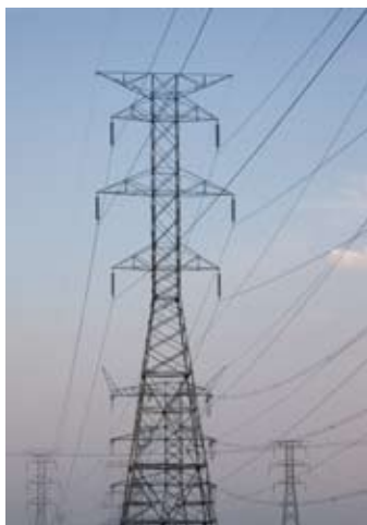
Torre de alta tensión
