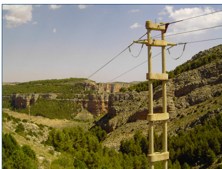
Fig. 10: Lín. (15 Kv) de Campillo de Aragón a Calmarza; remodelada en 2004 por ERZ-Endesa en la ZEPa de las Hoces del Río Mesa.
