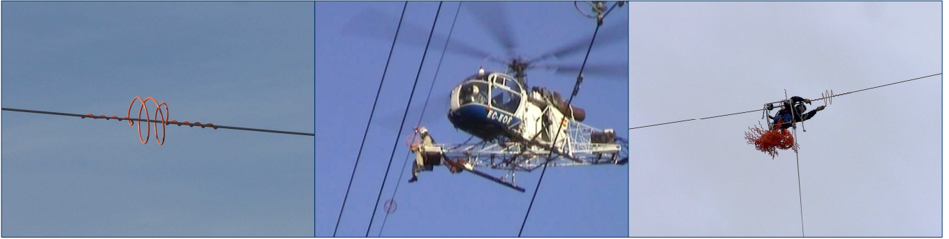
Fig. 13: Balizas salvapájaros utilizadas en los hilos de tierra de los tendidos de transporte (REE).
