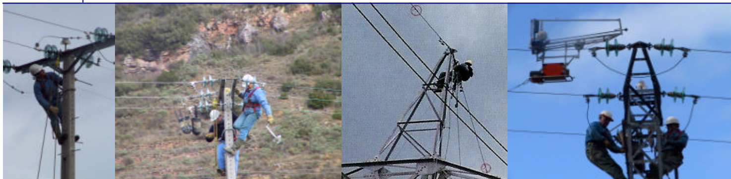
■ Eliminación de puentes flojos dominantes ■ Balizamiento de los hilos de tierra ■ Señalización de conductores mediante robot.
