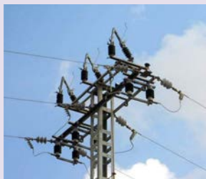
Seccionadores e interruptores
