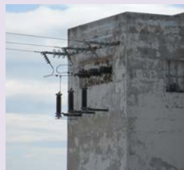
Caseta de transformación
