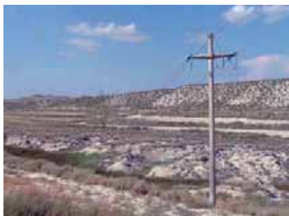
Der. (15 Kv) al Vedado de Zuera.
