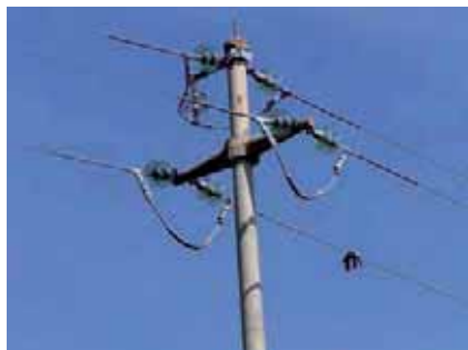
Detalle aislamiento apoyo.
