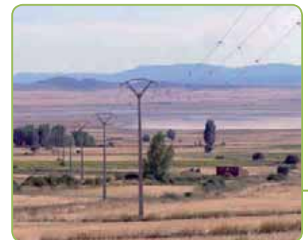
Línea de distribución señalizada en las proximidades de la Laguna de Gallocanta.
