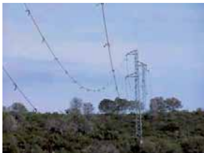
Efecto de la señalización de los hilos conductores.
