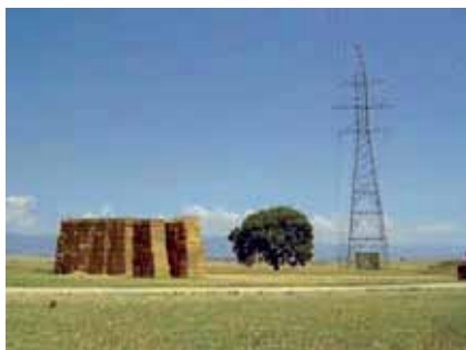
Lín. (220 Kv) de Sabiñánigo-Gurrúa.
