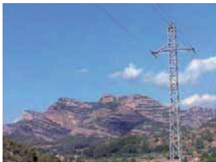
Lín. (15 Kv) de Valderrobres a Beceite y Der. a la Fábrica de papel.
