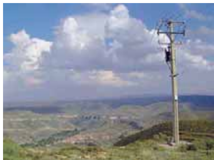
Lín. (15 Kv) de Cortes de Aragón a Josa.
