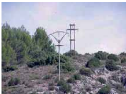
Der. (15 Kv) de Tosos al Embalse de Las Torcas.
